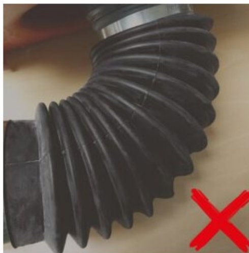
Неправильный монтаж. Гофротрубу нельзя использовать в качестве углового переходника.
