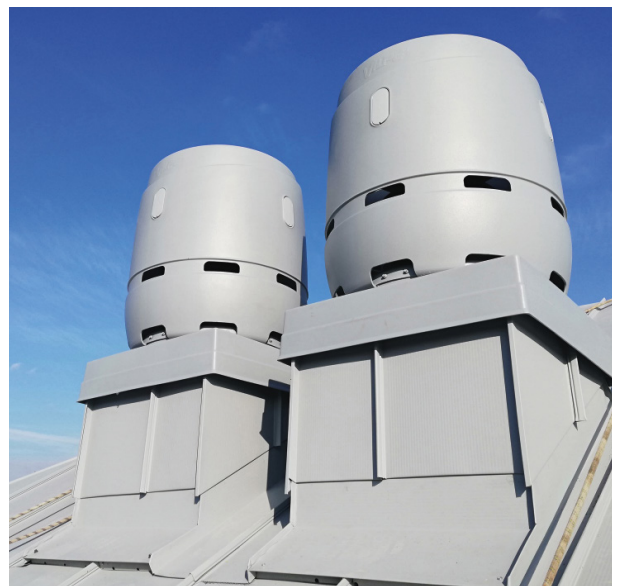
Sidabrinės-pilkos spalvos VILPE 315/400S FLOW ventilacijos kaminėliai, sumontuoti ant nuožulnaus stogo. Nuotraukoje pavaizduotus perėjimus sumontavo mūsų klientas.
